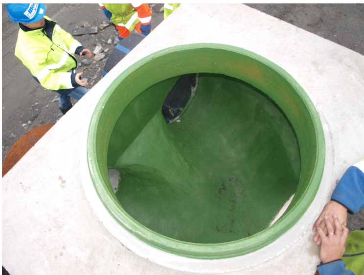
Bild: RV 155 Göteborg, inloppsbrunn ALFA SVR Elementbrunn
